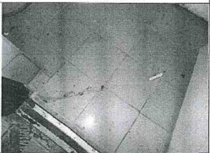
fürdő – WC, padlóburkolat repedés
