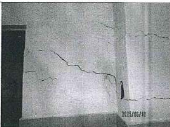
fürdő – WC repedés
